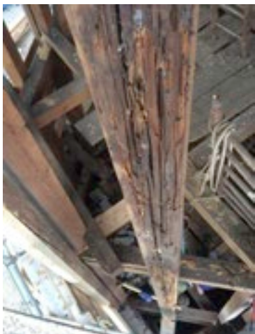
Morsche Stellen am Dachstuhl
